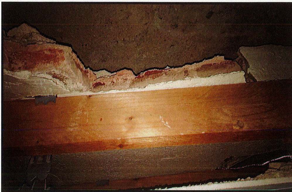
Photo 4 : Chape désolidarisée de la voute.
