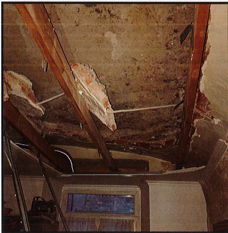
Photo 5 : Structure voute effondrée de type arc : « cintre presque à plat »
